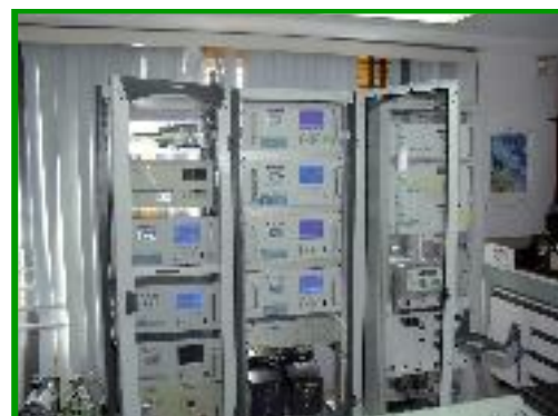
Matériel pour le raccordement à la chaîne nationale d'étalonnage
